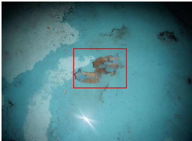
배수지2지 하부슬래브 도장박리
