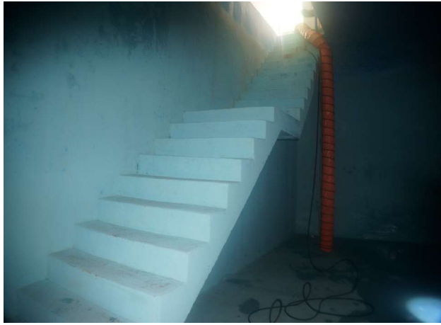
배수지 내부 안전난간 미설치
