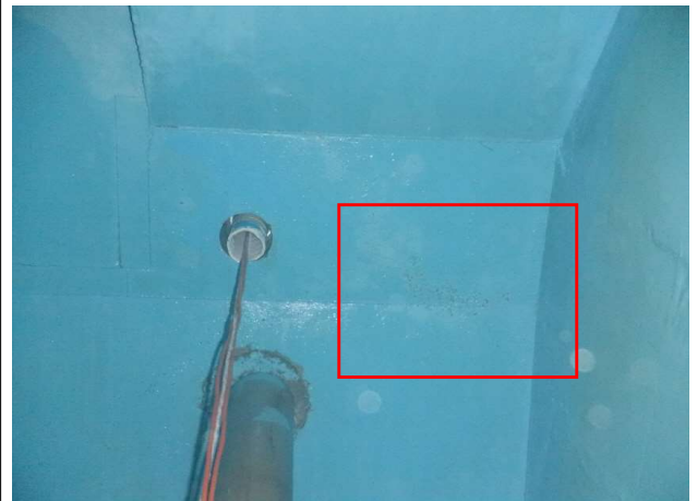
배수지1지 상부슬래브 재료분리
