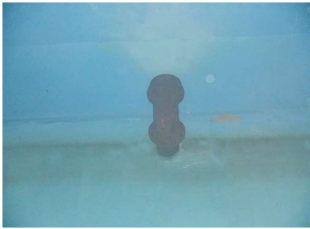
배수지 1지 유입배관 관부식
