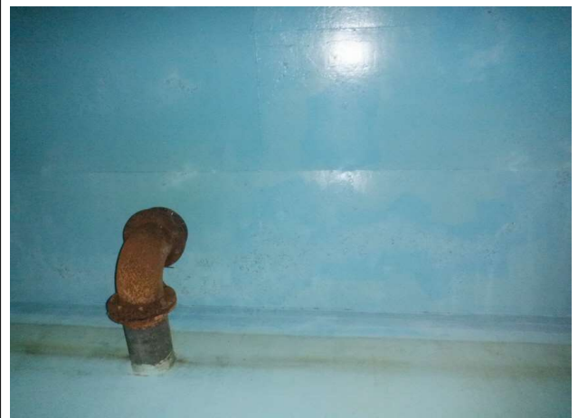
배수지 2지 유입배관 관부식
