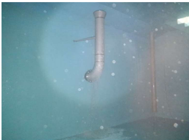
배수지 1지 유입배관 차수불량
