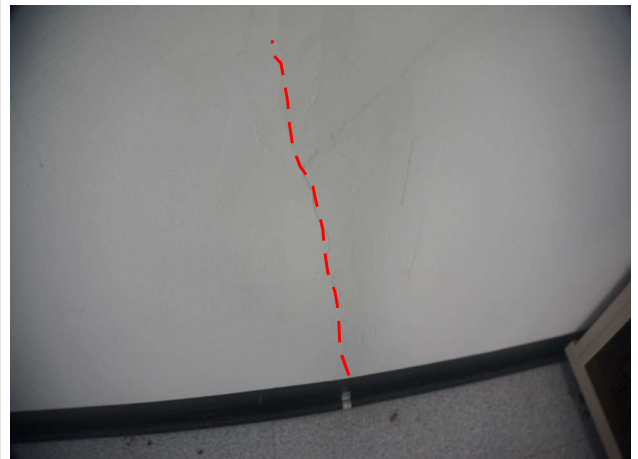
관리동 내부벽체 균열(0.3mm미만)
