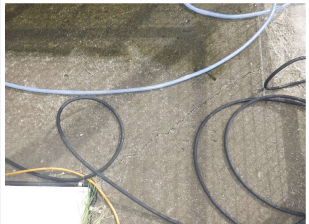
계단실 외부 바닥 균열(0.3mm이상)
