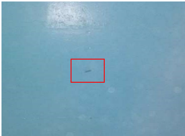
배수지1지 상부슬래브 녹
