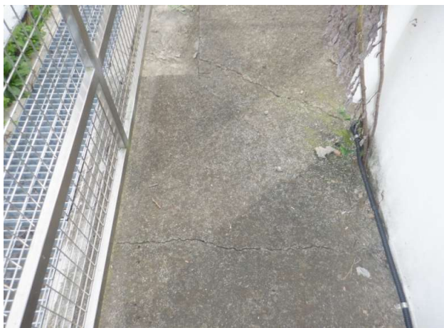
계단실 외부 바닥 균열(0.3mm이상)
