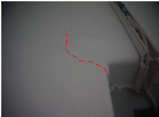
관리동 내부벽체 균열(0.3mm미만)
